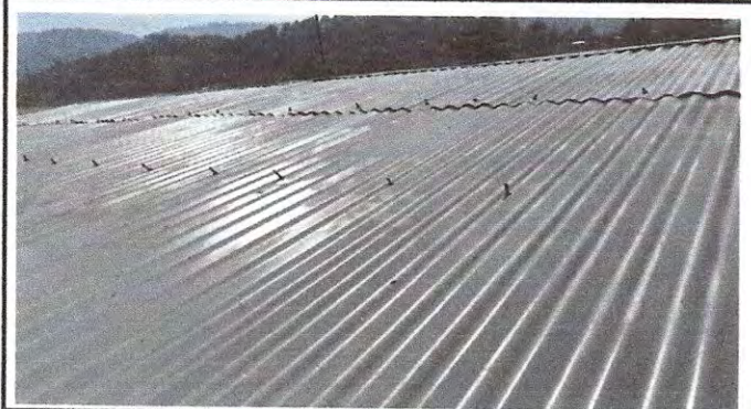
Foto 3: En la foto se observa el techo de la cuela que se pinto con el sobrante del reglón de sustitución de inodoro.
